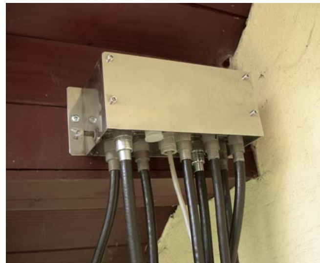
Przełącznik anten znajduje się na zewnątrz budynku
